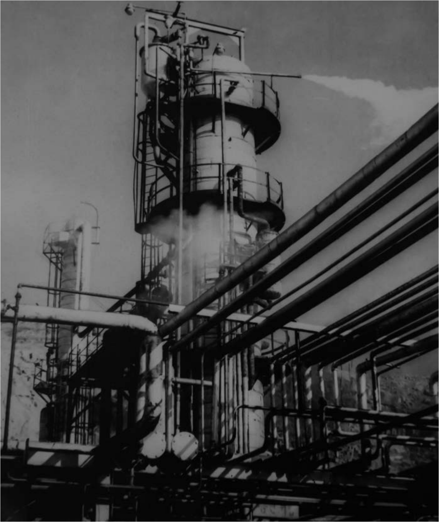
정상 가동 중인 감압증류탑
